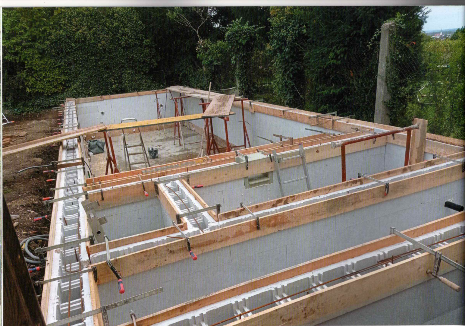
▲ Das Verfüllen der Wände mit Beton ist vorbereitet. Alle Wanddurchlässe sind eingebaut. Zusätzliche Schalbretter sorgen für den deckenden Abschluss der Wände nach oben.
